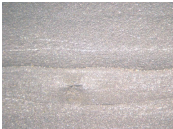
Foto 3 - Região interna do trecho de tubo, evidenciando a falha. Observa-se que a mesma ocorreu na região de costura do tubo
